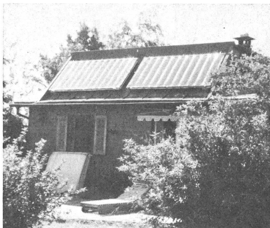
Sonnenkollektoren zur Erzeugung von Warmwasser und zur Heizung in der Übergangszeit
