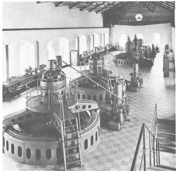
Fig. 2 Maschinensaal des Kraftwerkes Wynau nach dem Umbau 1937
