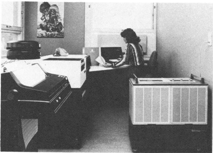
Verdunster-Luftbefeuchter in EDV-Anlage (Defensor AG)
