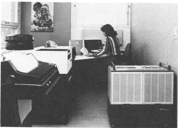
Verdunster-Luftbefeuchter in EDV-Anlage (Defensor AG)
