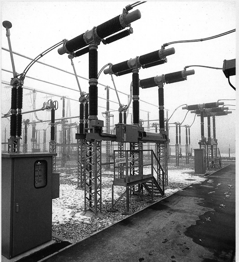
245 kV-SF 6 -Leistungsschalter, Typ 3AS2 im Unterwerk Sursee der CKW.
