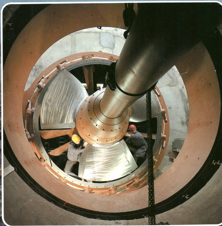
▲ Eine S-Turbine von Bell mit einem Laufrad-Durchmesser von 3200 mm deckt seit Frühjahr 1981 einen wesentlichen Teil des Energiebedarfes für die Papierfabrik Perlen/LU.
