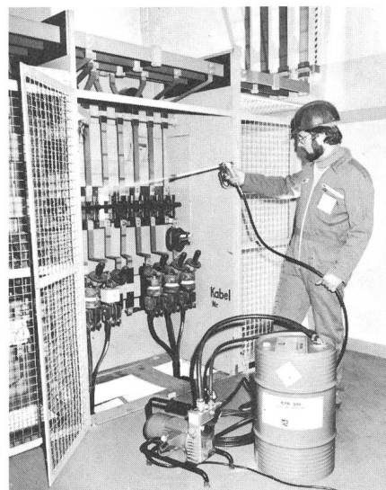
Fig. 1 Vorsicht Spannung! Das Reinigen von Schaltanlagen unter Spannung soll nur mit geprüften Elektroreinigungsmitteln und den entsprechenden Betriebsmitteln vorgenommen werden.
