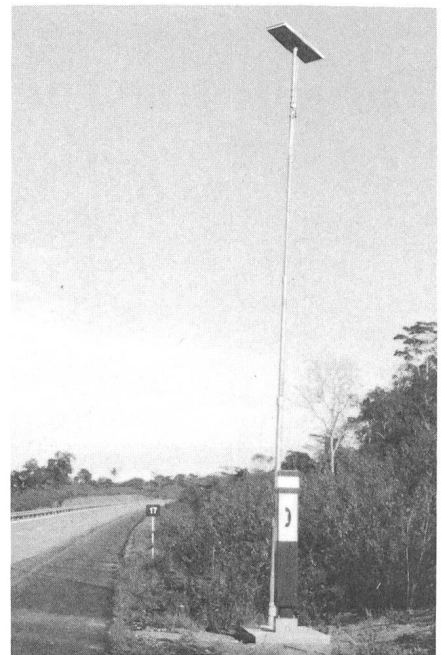
Fig. 4 Notrufsäule mit Antennenmast und Sonnenenergiespeisung
