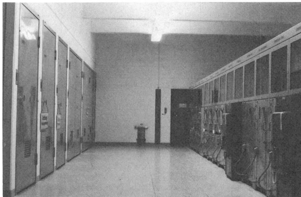
Fig. 6 Station Fernheizkraftwerk; geschlossene Bauweise, Baujahr 1979
