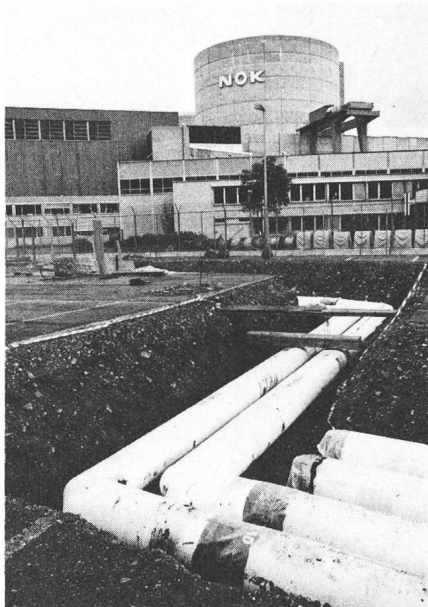
Fig. 4 Fernwärmeleitungen auf dem Inselareal Beznau
