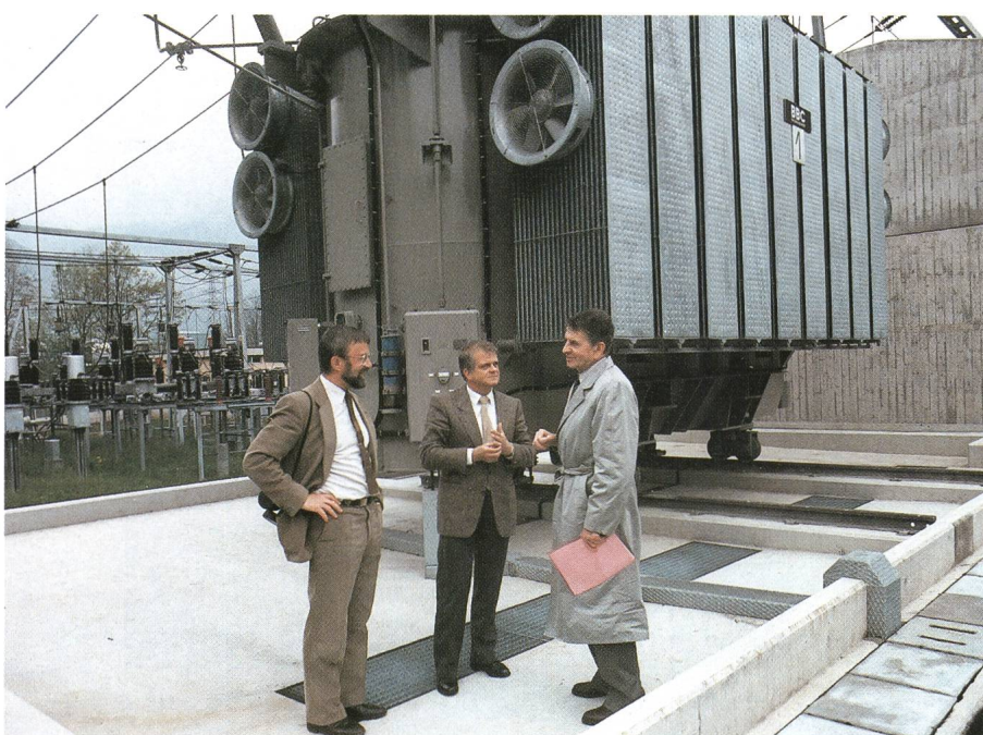
Sous-station de Mendrisio avec deux transformateurs de 100 MVA, 150/50 kV lors de l'inspection des mesures de mise à terre par l'Inspectorat fédéral à courant fort
