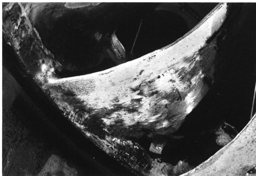
Fig. 3 Beispiel eines inspizierten Turbinlauftrades mit repariertem Schaufelaustritt
