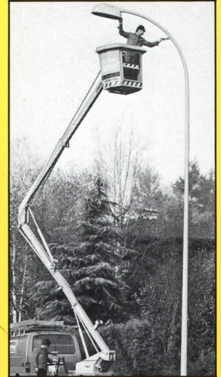
Korrosionsschutz an Stahlkandelabern
