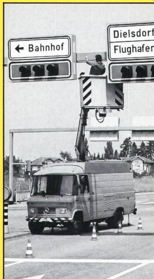
Korrosionsschutz an Signalanlagen
