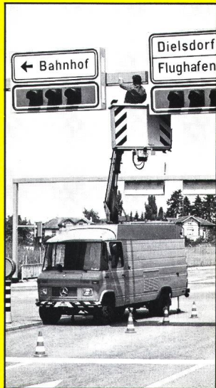
Korrosionsschutz an Signalanlagen
