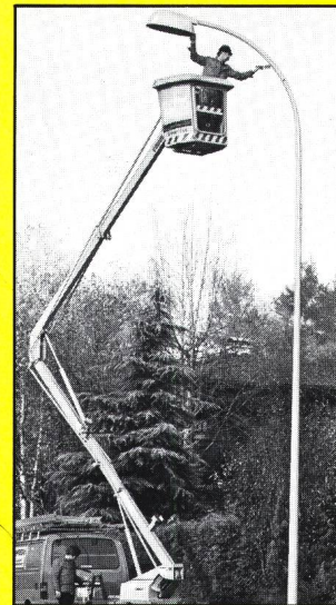
Korrosionsschutz an Stahlkandelabern
