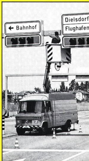
Korrosionsschutz an Signalanlagen
