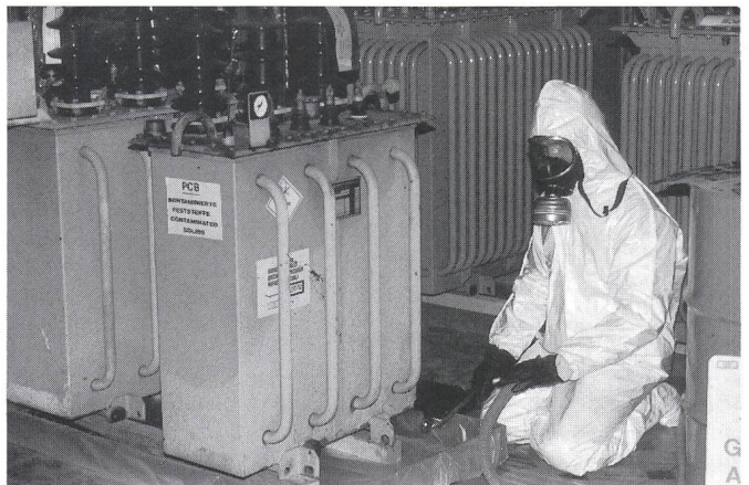
Figur 4 Zum Abpumpen bereitgestellte Trafos mit PCB-verseuchtem Isolieröl
