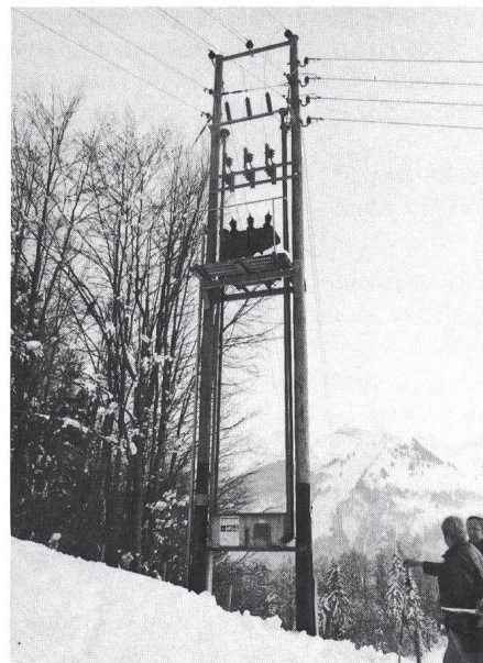
Figur 6 Nach Annäherung an Hochspannungssicherung wurde Schaltwartin vom PoDEST geschleudert
