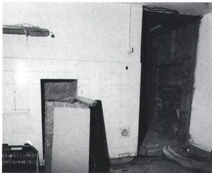
Figur 10 Unerlaubte, fehlerhafte Laieninstallation tötete einen Heizungsmonteure
