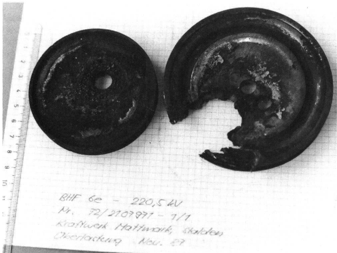
Bild 2 Schadensbild 220-kV-Funkenstrecken- ableiter
