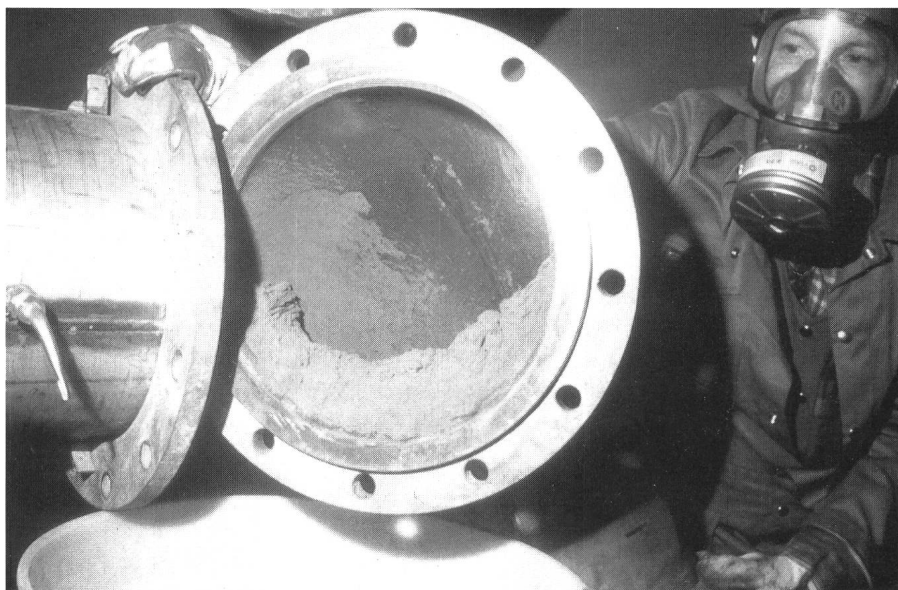
Bild 5 Im unvollendet gebliebenen Kernkraftwerk Marviken, Schweden, wurden Aerosol-Freisetzungsversuche aus Reaktorbauteilen voller Grösse – Reaktor-druckbehälter und Druckhalter – angestellt. 16 Organisationen aus Europa, Nordamerika und Asien beteiligten sich an den Kosten von insgesamt 30 Millionen US-Dollar. Die Versuche mit nicht radioaktivem Jod, Cäsium und Tellur haben u.a. gezeigt, dass sich in der Rohrleitung zur Druckentlastung des Reaktor-druckbehälters grosse Mengen Aerosole ablagern.
