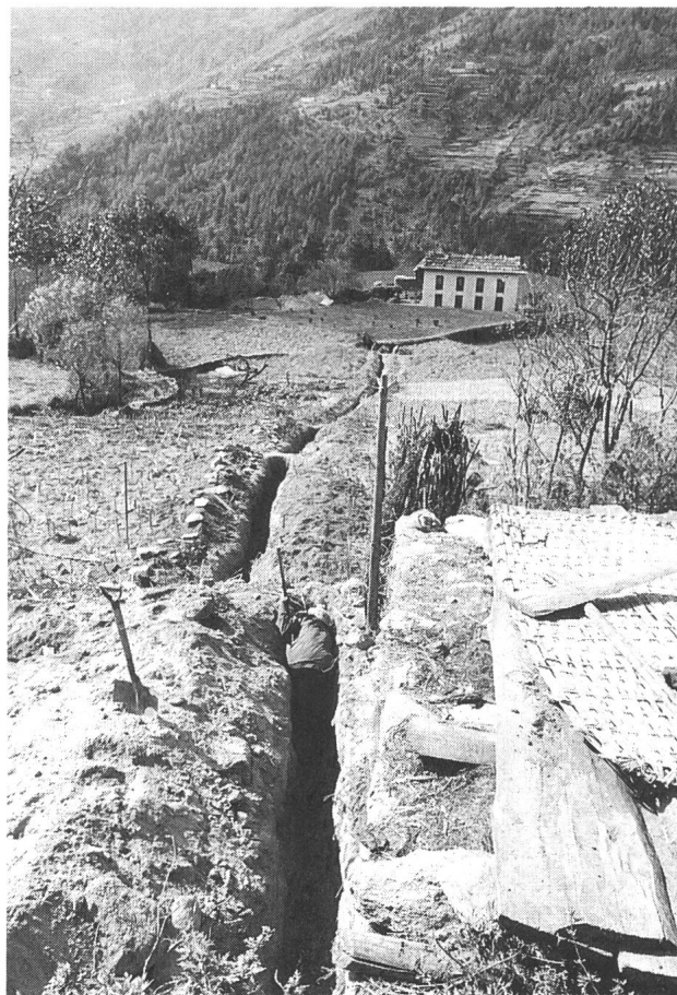
Bild 7 Die Verkabelung des Niederspannungsnetzes erfolgt ausschliesslich in Handarbeit
