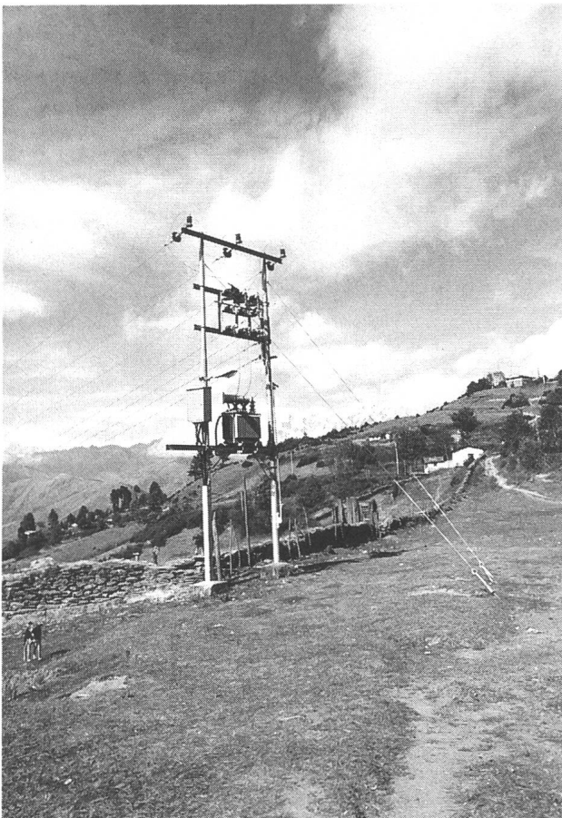
Bild 9 Das Ende einer der drei vom Werk ausgehenden 11-kV-Stichleitungen mit Trennschalter und Freilufttrafo, hier in Chialsa auf fast 3000 m Höhe
