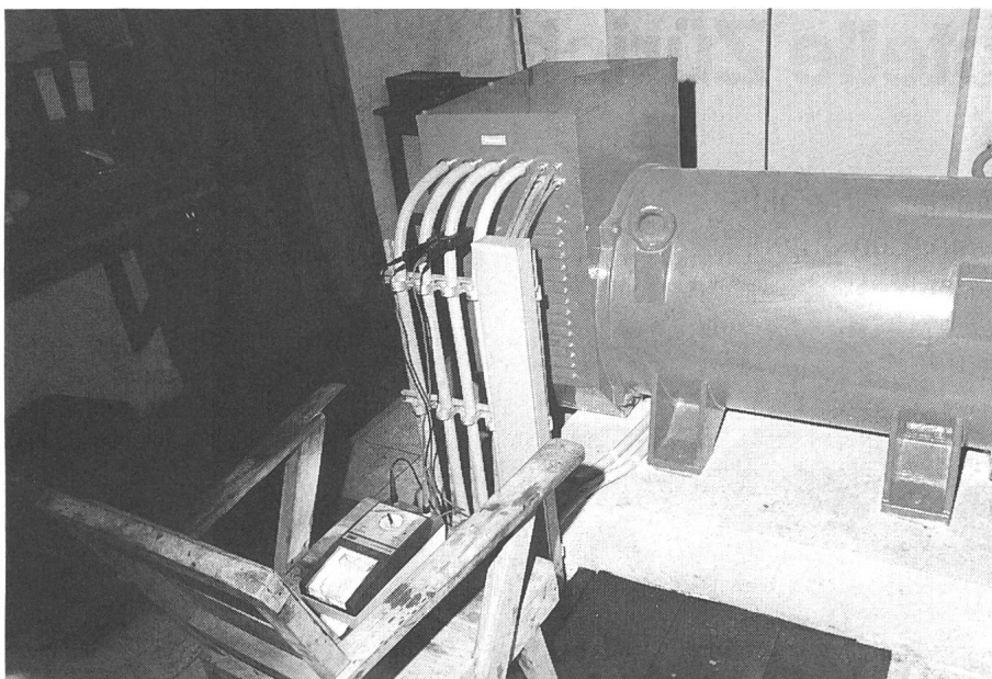
Bild 3 Es geht auch mal ohne Schweizer Perfektionismus: Provisorium zur Aufzeichnung der Lastkurve mit einem einfachen Registriergerät und Stromzange an einer der drei Generator- Phasen
