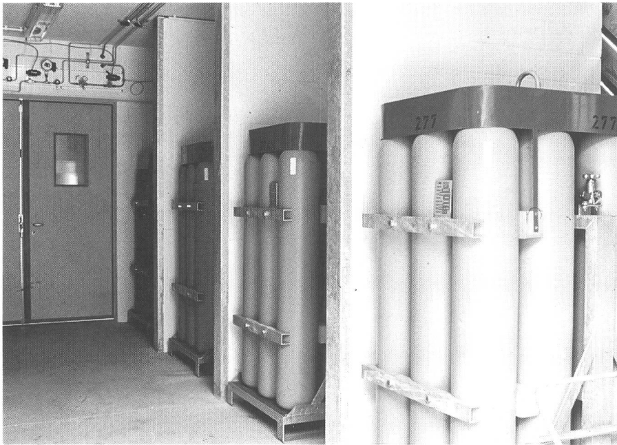
Bild 3 Speicherbatterien für gasförmigen Wasserstoff (Inhalt je 120 m 2 , entsprechend 360 kWh)
