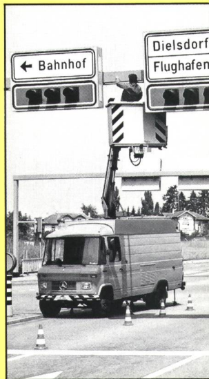
Korrosionsschutz an Signalanlagen
