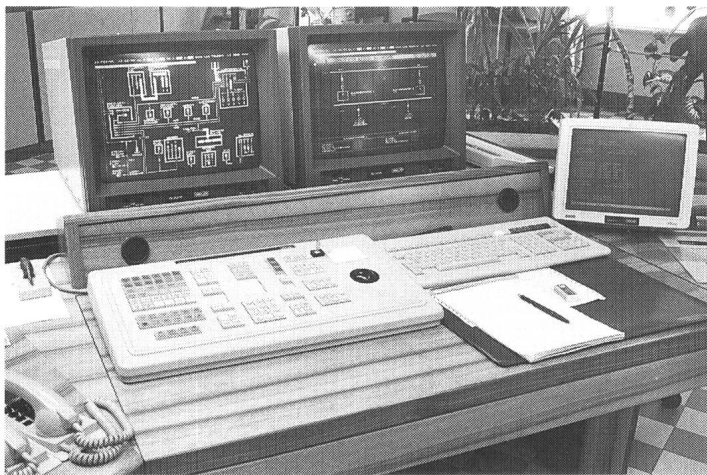
Bild 8 Netzleitstelle in der Zentrale Lütschental
