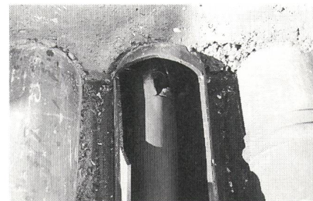
Bild 6 Rohrblock mit PE-Rohren PE-Rohre verhalten sich im Kurzschlussfall einwandfrei
