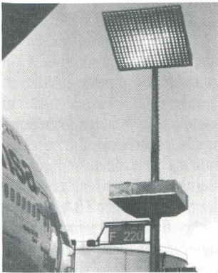
Neue Vorfeldbeleuchtung am Frankfurter Flughafen
