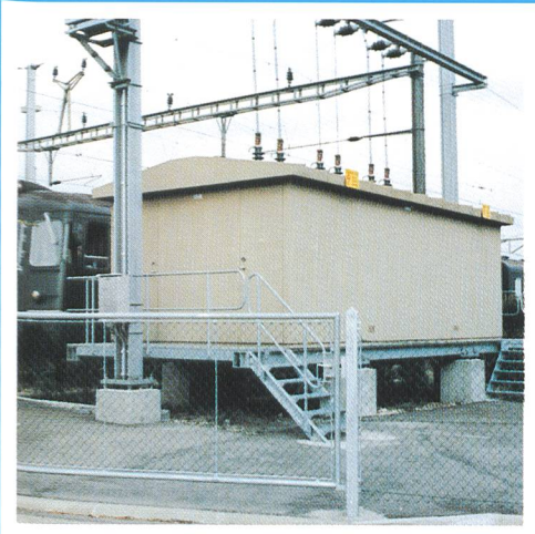
Poste de couplage pour ligne de contact Schaltposten für die Fahrleitung
