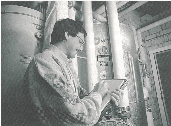
Bild 14 Der Berater des Elektrizitätswerkes überprüft den Zustand der Boiler (Bild: Fotostudio Hans Eggermann, Luzern)
