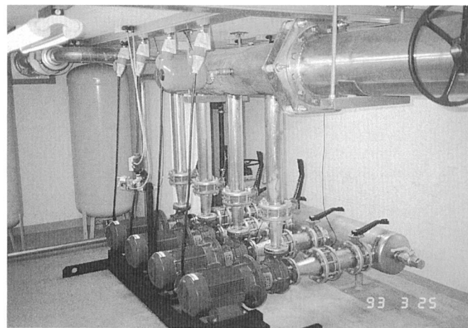
Station de pompage pour le réseau Révalpie
