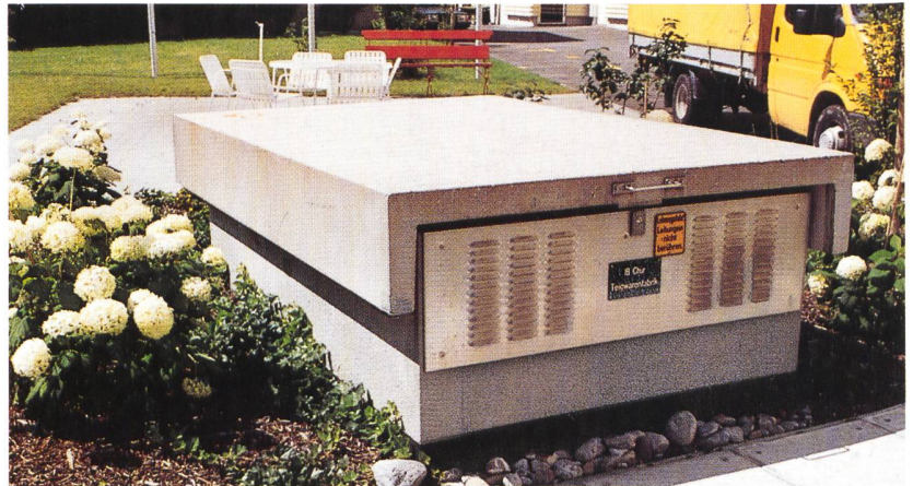
Fertig-Transformatorstation, Typ: Unterflur C
