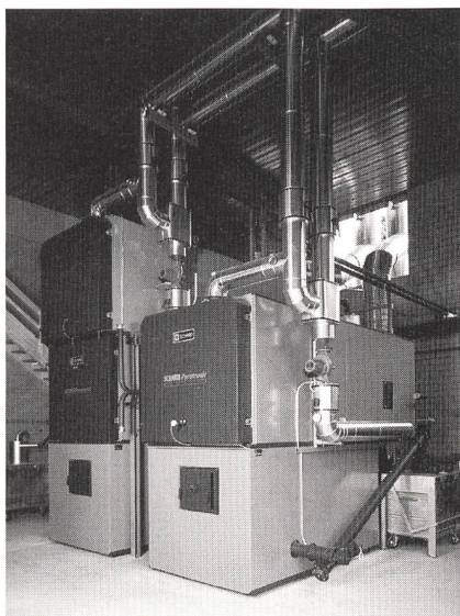
Bild 10 Mit Restholz Heizöl und Erdgas substituieren: Schnitzelfeuerungen in der Sägerei Aecherli in Regensdorf (Foto: Aecherli).
