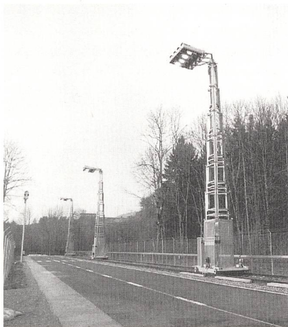
La route de démonstration d'éclairage public des EEF à Electrobroc, qui a été inaugurée le 9 mars 1995.
