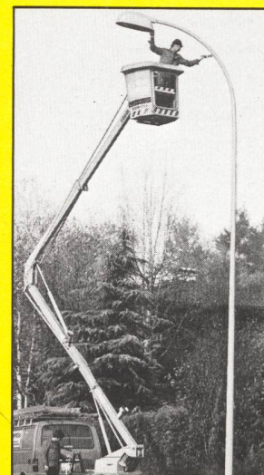
Korrosionsschutz an Stahlkandelabern
