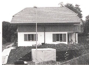
Eine kleinere Trafostation Explo von Gram SA
