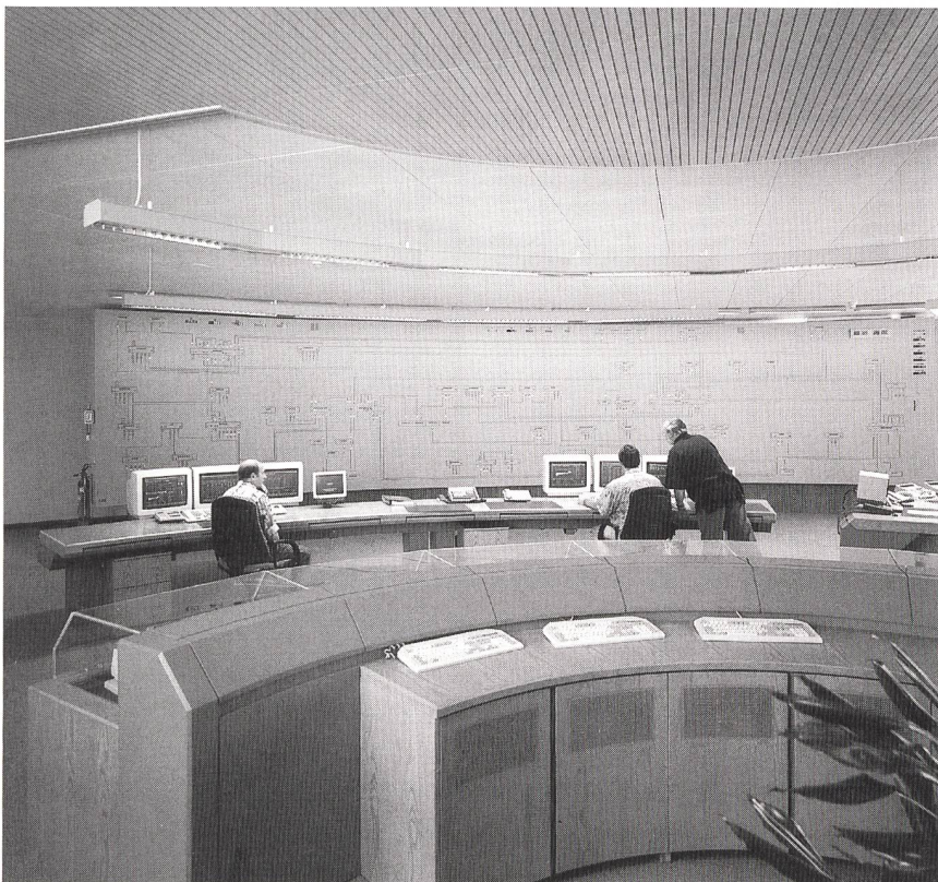
Bild 3 Blick in den Kommandoraum des Betriebsführungszentrums.
