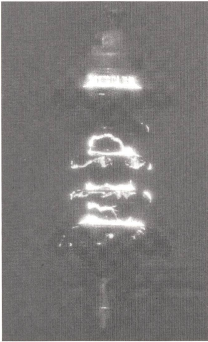
Bild 2 Funkenentladungen und Teillichtbögen an Stützisolator
