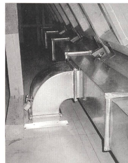
Bild 3 Heissluft-Sammelkanal nach Luftkollektoren.
