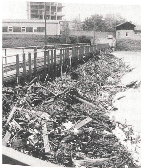
Verteuert den Strompreis: Entnahme und Entsorgung des «Geschwemmsels».
