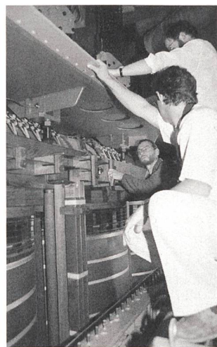
Figura 3 Ispezione del trasformatore.
