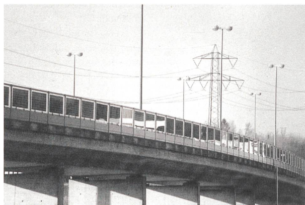
Beidseitig lichtempfindliche PV-Module an Schallschutzwand auf der Autobahnbrücke.
