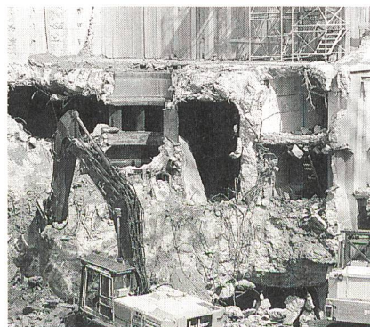
Der Abbruch des Maschinenhauses, der Betonspiralen und Saugrohre erfolgt mit Hydraulikbaggern mit Abbauhammer und Hydraulikscheren.
