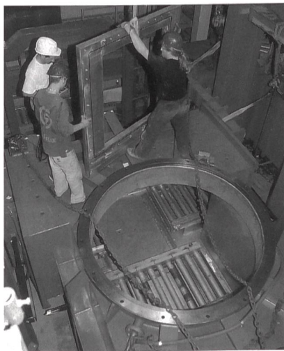
Der Plasma-Ofen wird montiert. Sein Lichtbogen kann neben brennbaren auch unbrennbare radioaktive Abfälle zersetzen und aufschmelzen.
