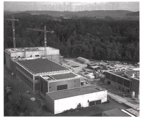
Ausser der «Heissen Zelle» sind im Zwilag ab Mitte Dezember 1999 sämtliche Anlagen für die Zwischenlagerung radioaktiver Abfälle betriebsbereit.
