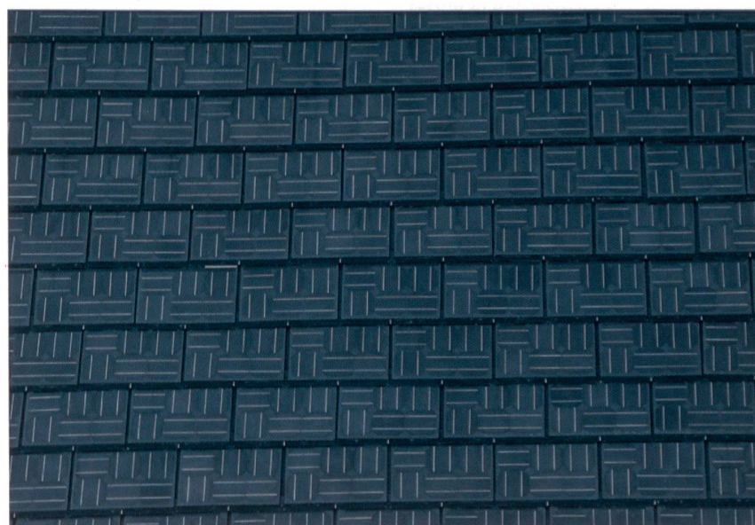
Detailansicht einiger der 16650 Solardachziegel auf dem neuen Getreidemagazin in Bern (Bild EW Bern).
