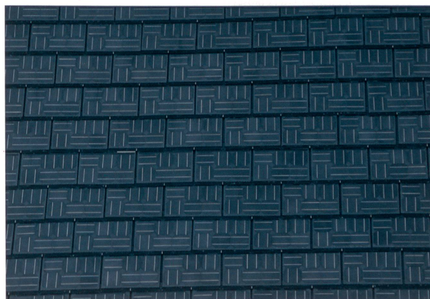
Detailansicht einiger der 16650 Solardachziegel auf dem neuen Getreidemagazin in Bern (Bild EW Bern).
