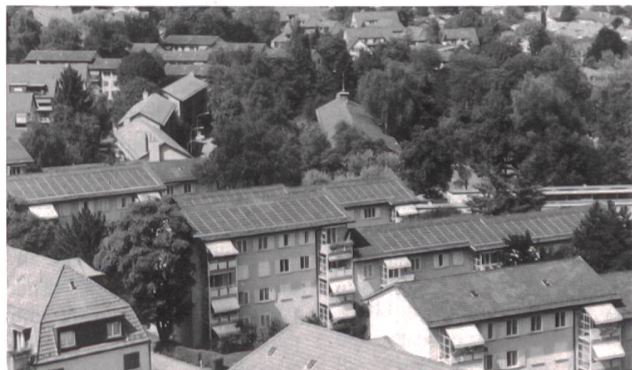
53,04-kW p -Photovoltaik-Anlage auf den Dächern der Wollishofer ABZ-Kolonie im Moos
