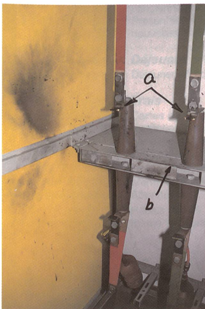
Bild 12 Schalterkontakte, an denen ein Erdschluss erzeugt wurde
