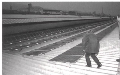
Die Solarstromanlage auf dem Perrondach des HB Zürich bei Einbruch der Dunkelheit.
