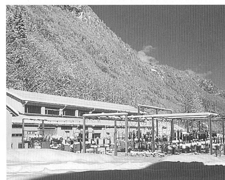
Gesamtüberblick Fätschbachwerk mit 50-kV-Schaltanlagen.
