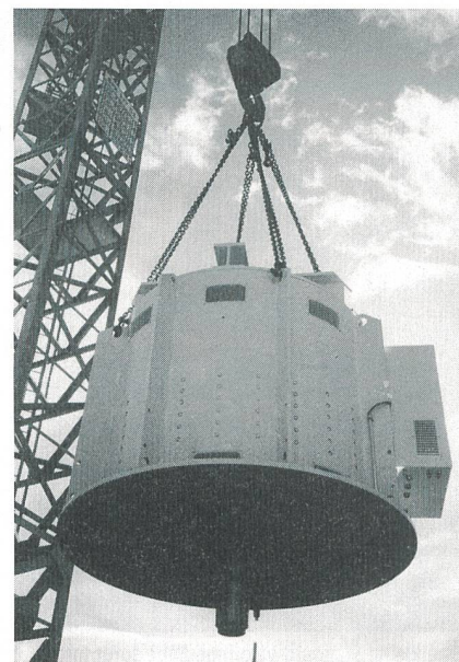
Die Generatoren erreichen bessere Wirkungsgrade als Schnellläufer und Getriebe zusammen.
