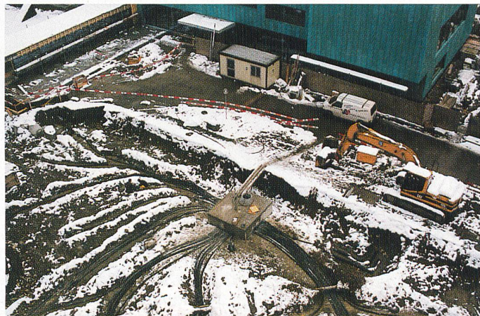
Bild 6 Verlegte Zuleitungen zu den Erdwärmesonden bzw. zum Sammel-schacht. Aufnahme vom 28 m hohen Turm des Eidgenössischen Amtes für Messwesen.
