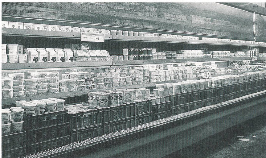
Bild 2 Kühlanlage in einem Supermarkt: Risiken müssen noch detaillierter untersucht werden.
