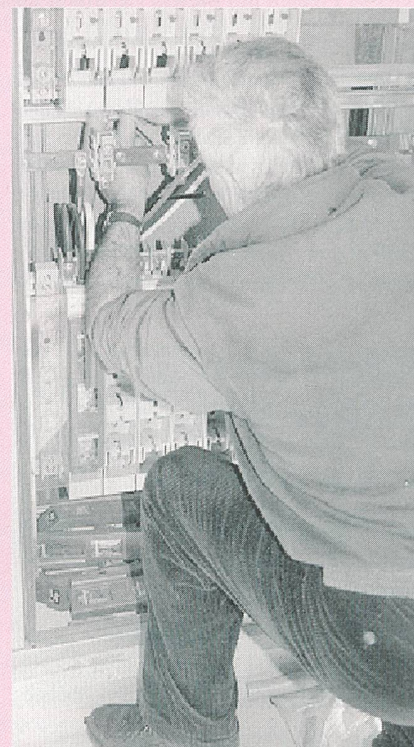
Unter Spannung stehende Teile abdecken / Recouvrir les pièces sous tension
